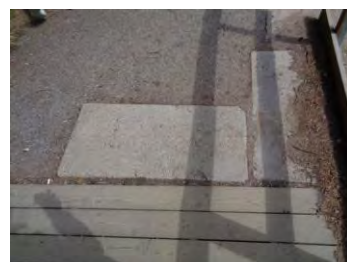
Bild 23: Åtgärda kant på konsolbrygga
